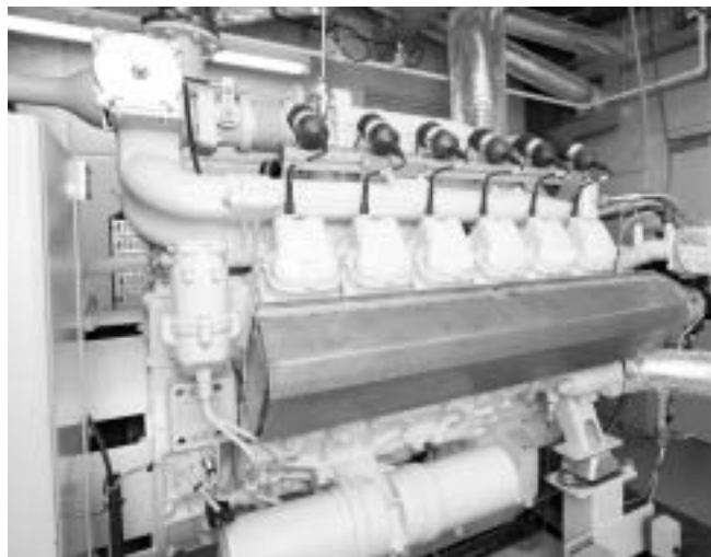
図5 ガスエンジン外観 Fig.5 External view of gas engine
