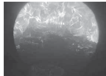
バイオマスボイラ燃焼状況
