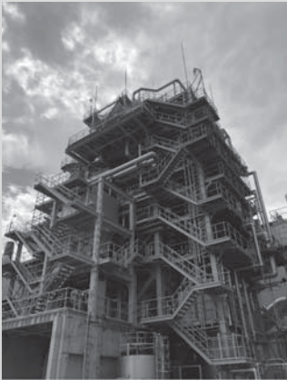
写真2 廃熱ボイラ photo2 Waste heat boiler
