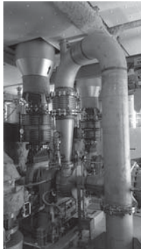
図3 葛西水再生センター焼却設備の外観写真① Fig.3 The picture of Kasai water Reclamation center incineration system(1)
