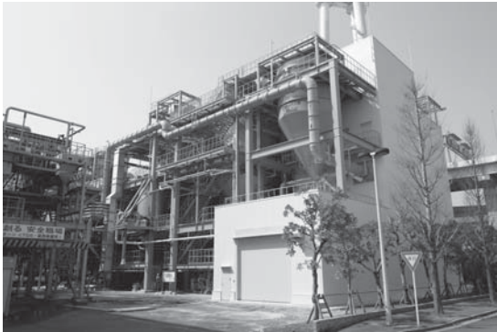
図3 葛西水再生センター焼却設備の外観写真② Fig.3 The picture of Kasai water Reclamation center incineration system(2)
