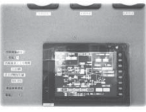
図6 現場盤にある操作用TP Fig.6 Touch panel for operating on the local control panel
