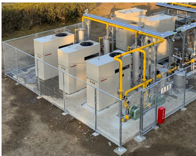
消化ガス発電設備
