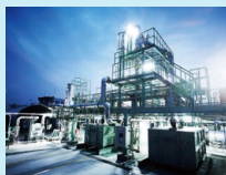
脱水乾燥システム (下水処理場)
