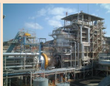
固形物 焼却設備
