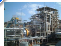
固形物焼却設備
