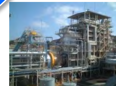
固形物焼却設備
