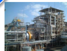
固形物焼却設備
