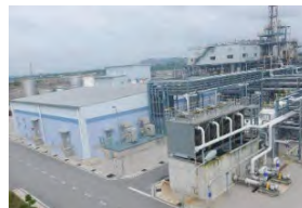
海外大型プラント (マレーシア)
