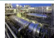
下水汚泥 燃料化システム
