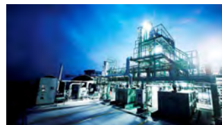
脱水乾燥システム
