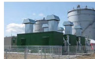
穴道湖東部発電所
