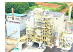
廃棄物処理設備
