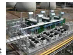
消化ガス発電事業
