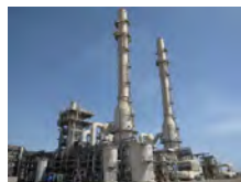
廃液燃焼システム
