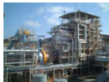
固形廃棄物処理設備
